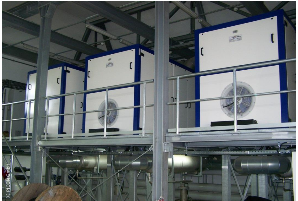
BHKW Anlage Kläranlage Zittau nach Neuaurüstung 2013
