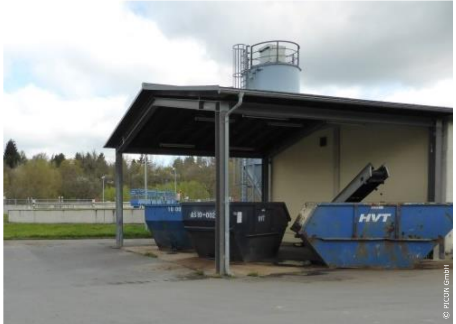
Klärschlammabwurf in Absetzcontainer
