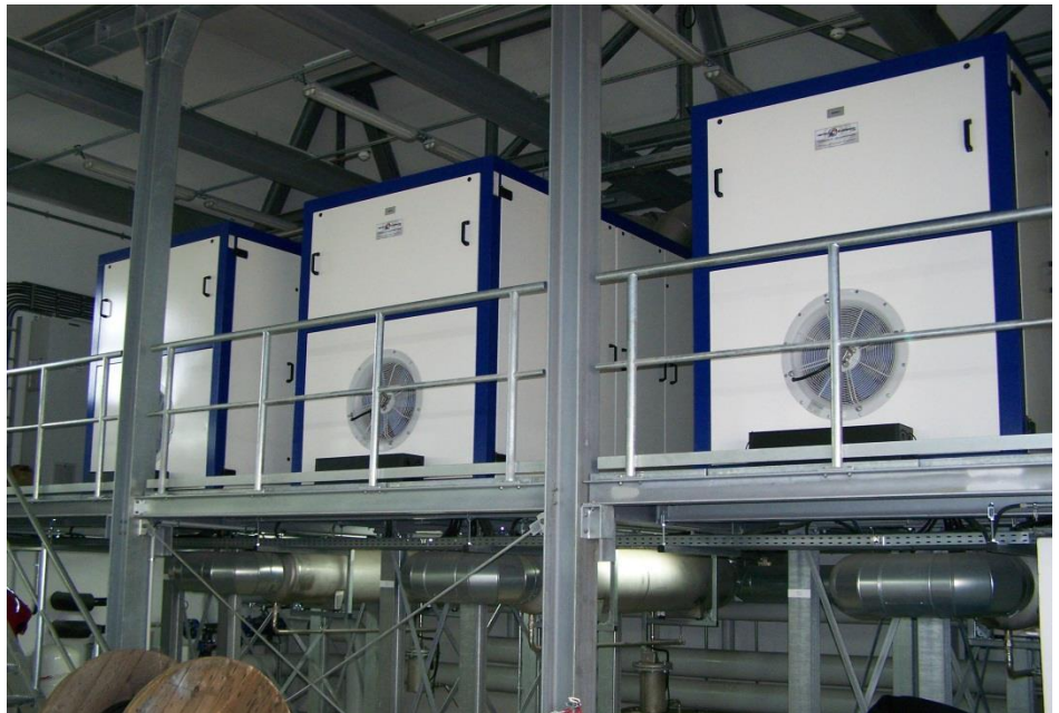
BHKW Anlage Kläranlage Zittau nach Neuaurüstung 2013
