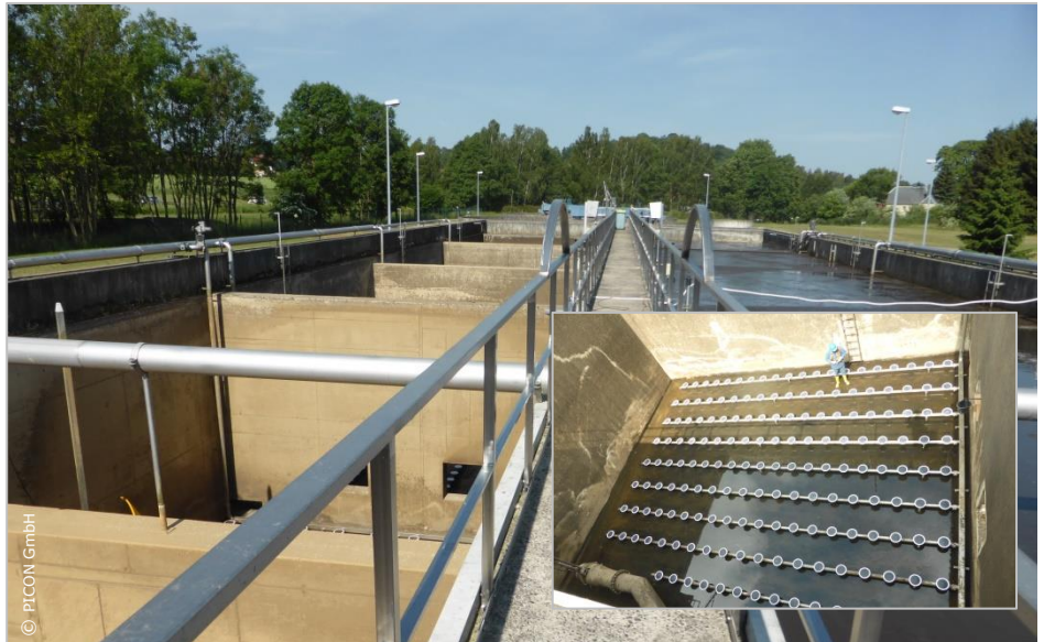
Belebungsbecken Kläranlage Ebersbach
