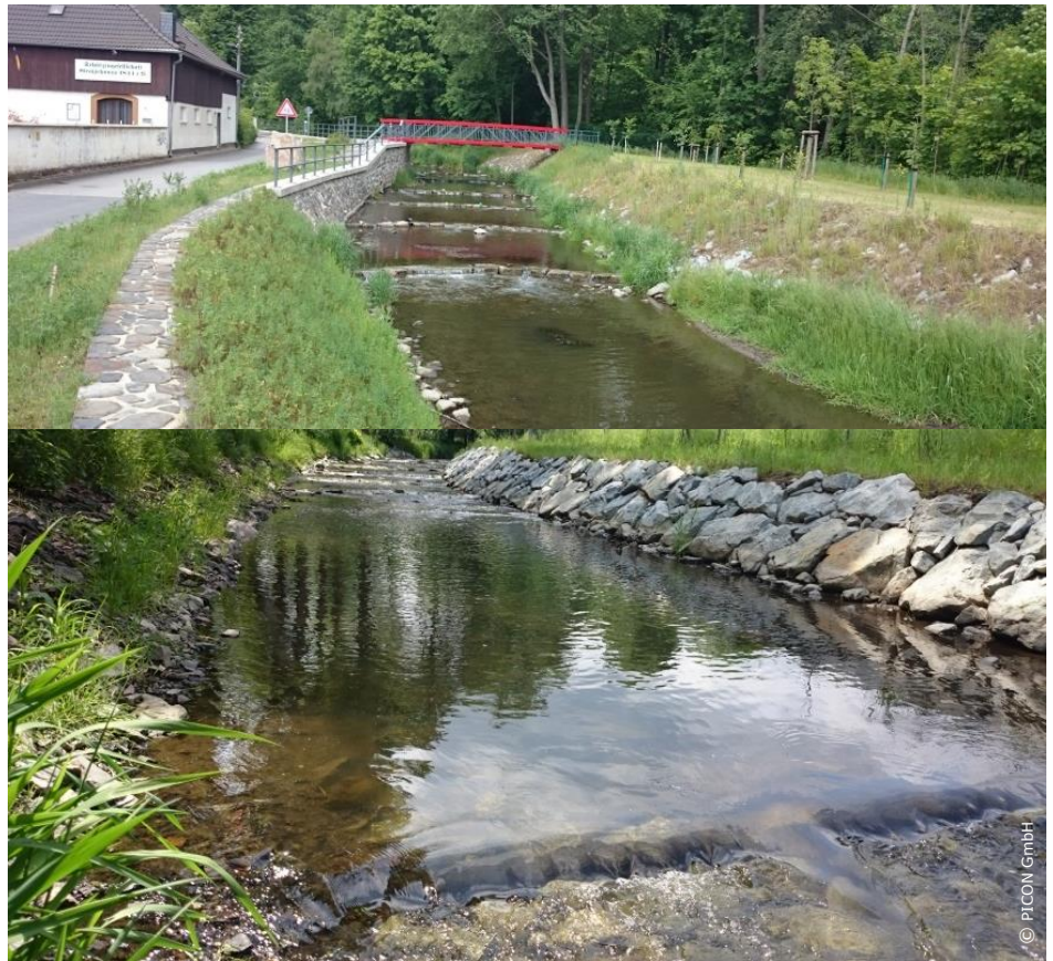
Sohlgleiten/-rampen in Riegel-Becken-Struktur
