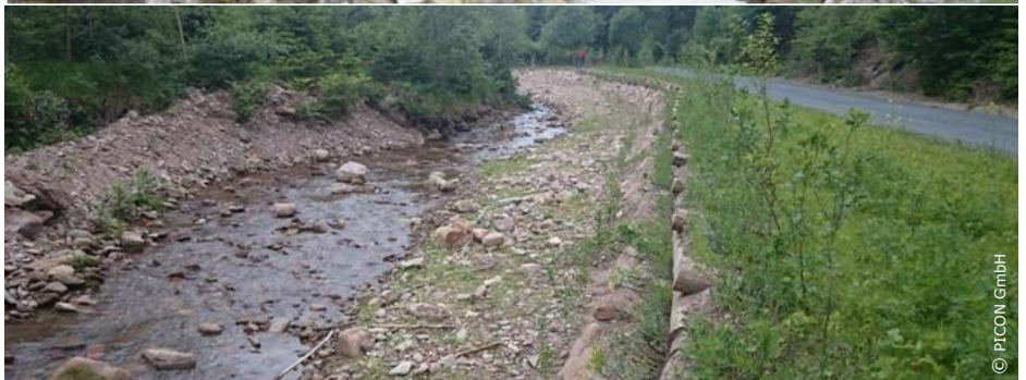
Forstweg mit Erosionsschäden oben und Böschung nach Fertigstellung unten
