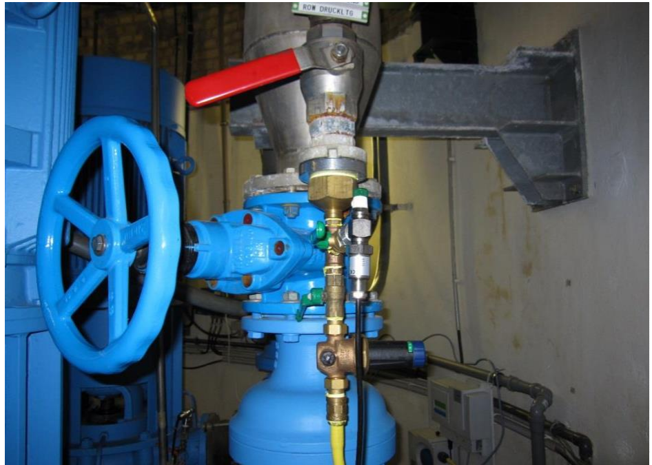
Druck- und Durchflussmessung im Brauchwassersystem
