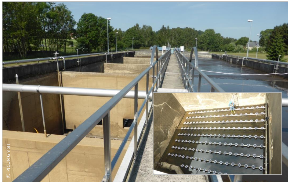
Belebungsbecken Kläranlage Ebersbach
